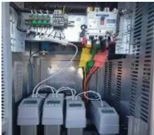
图 3-1 某台区低压无功补偿装置
