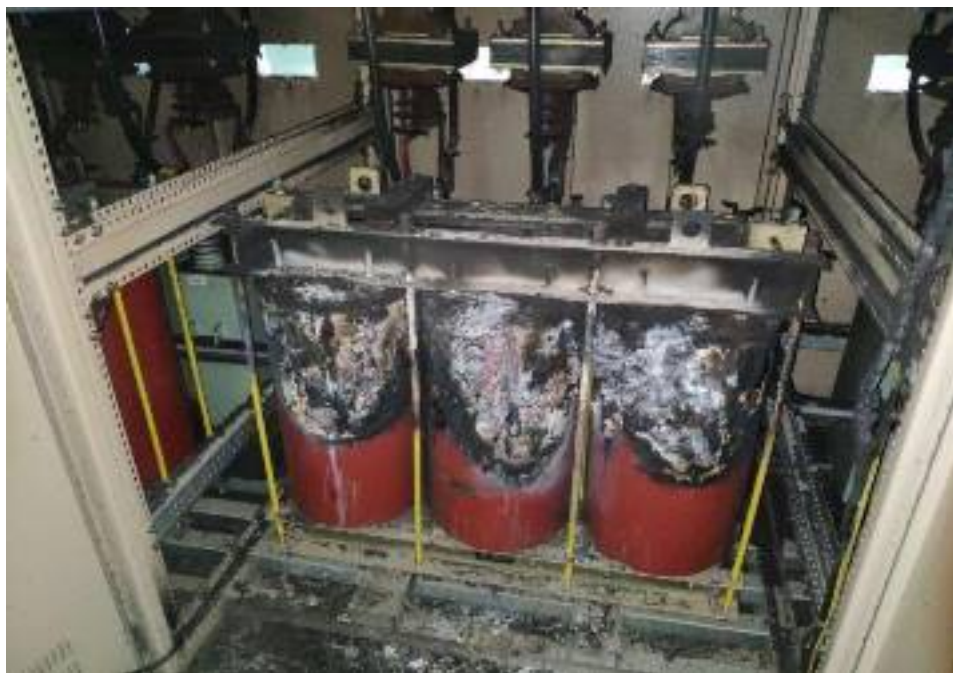
图 1 电容器组内电抗器损坏现场
