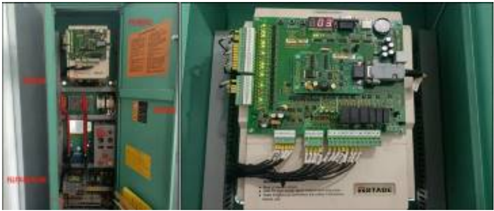
图 1 电梯控制柜内结构
